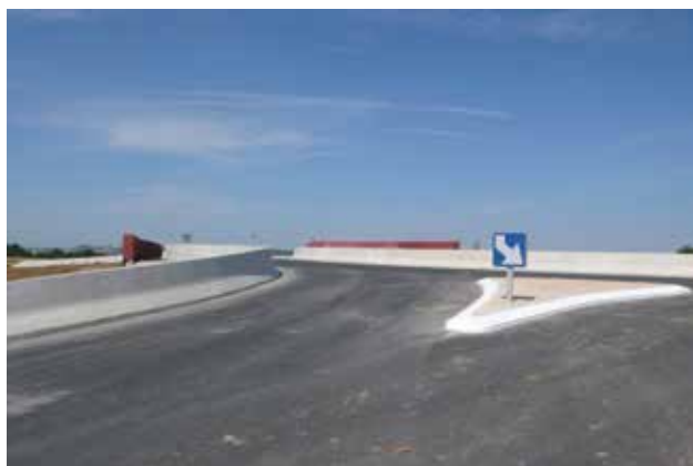
Ce sont les glissières de sécurité en béton du rond-point supérieur qui doivent être remplacées
